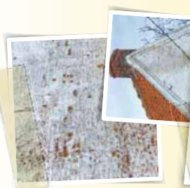
La première cause de propagation des champignons et moisissures est l'humidité !
